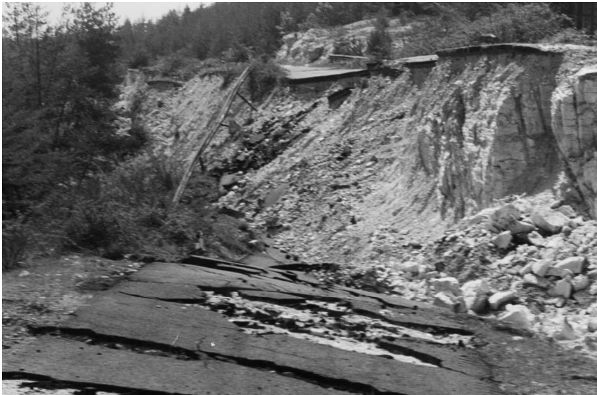
Фиг. 3. В резултат на вертикално пропадане е разрушен пътят за с. Генерал Гешево. Снимка – май 2001 г.
